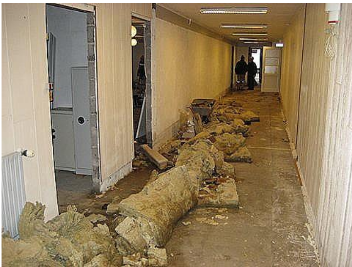
Gulvet i gangen er brudt op
